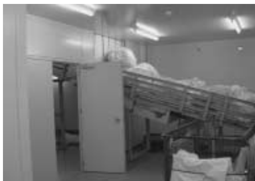
ゴミを滅菌・破碎する装置の投入口付近
